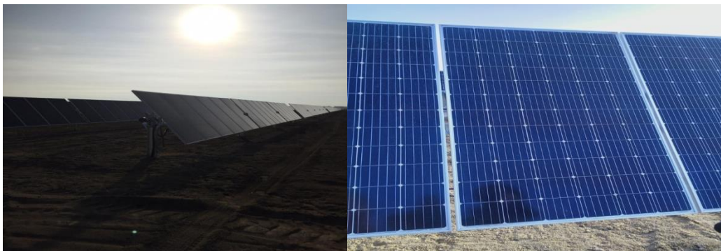
Рисунок 1 – Солнечные модули, установленные на СЭС
